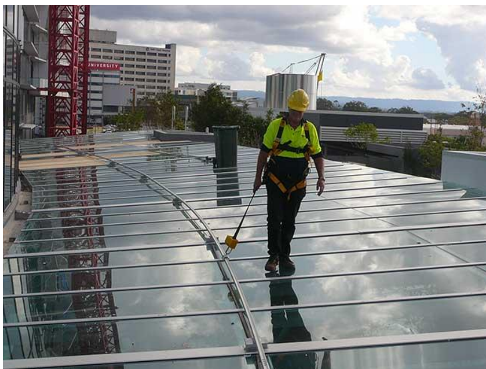
Figura 24. Exemplo de Sistema baseado em linha de ancoragem horizontal rígida. Fonte: CAI Safety Systems
